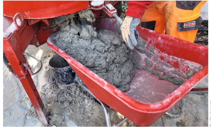
Bild 10 Entleerung des Mischer in die Schubkarre Deloading of the mixer into the wheelbarrow
